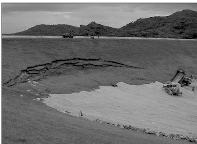
Panorámica del deslizamiento ocurrido en la presa Lebrije. También se observan hombres y equipos que trabajan para evitar su expansión.
